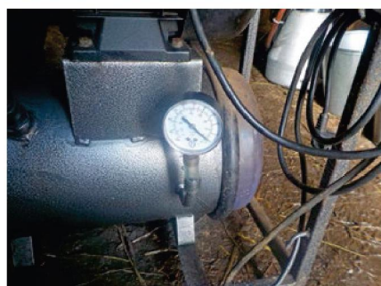
Ресивер установки с вакуумметрическим манометром
